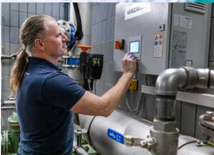
Das läuft: TEN-Mitarbeiter Marko Kleinheider inspiziert die technischen Anlagen und entnimmt regelmäßig Wasserproben, was wichtig für eine sichere Trinkwasserversorgung in Bad Iburg ist.
